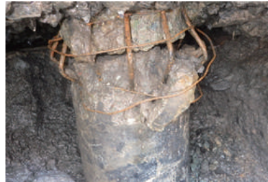
〈損傷した杭の様子〉
