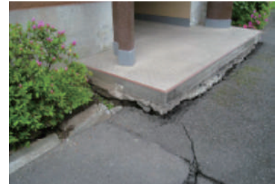
〈地盤が沈下し、液状化が発生〉
